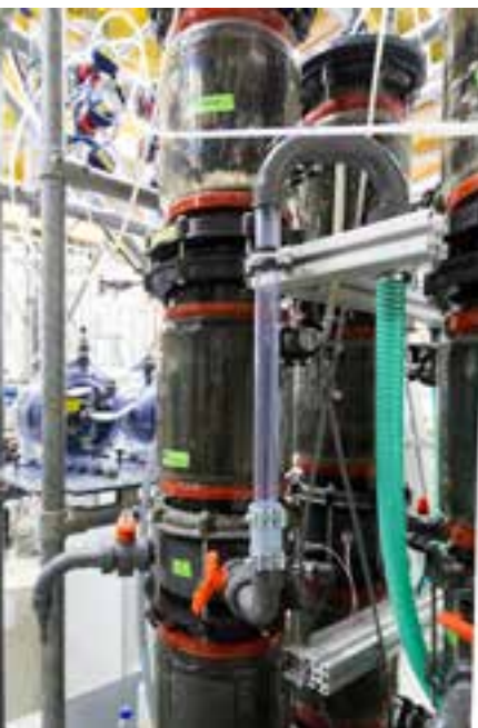
oben: Einstufige Anlage in Ilsfeld
